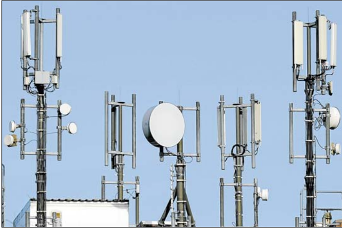
Antennen wie diese sorgen dafür, dass in Deutschland flächendeckend Handyempfang gewährleistet wird. Der Mobilfunkanbieter O2 kann jetzt eine Versorgungsschwäche im Bereich Milte ausmerzen.
